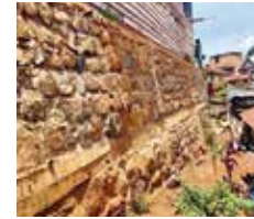
La construction de ce mur de soutènement était nécessaire pour sécuriser les fondations du premier bâtiment scolaire de Ciriri sur cette pente abrupte. | K 04
